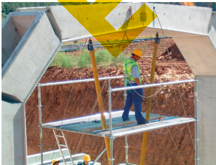
Foto 8: Detalle del uso de arnés de seguridad, al no ser posible el cierre perimetral de la plataforma de trabajo.
