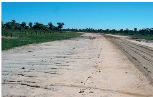
Figura 2.1_12. Margenes con erosión por desbroce y deforestación
