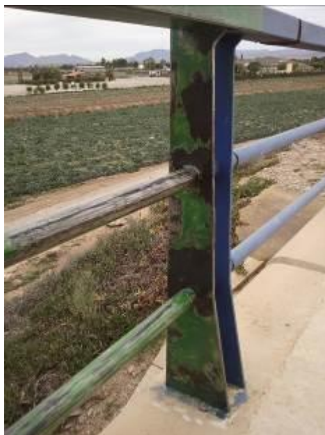
Figura 2. Preparación primaria consistente en la eliminación de la herrumbre suelta o fuertemente adherida, mediante un cepillado mecánico para conseguir un grado de preparación C St3 de las zonas que presentan óxido incluido el subyacente.
