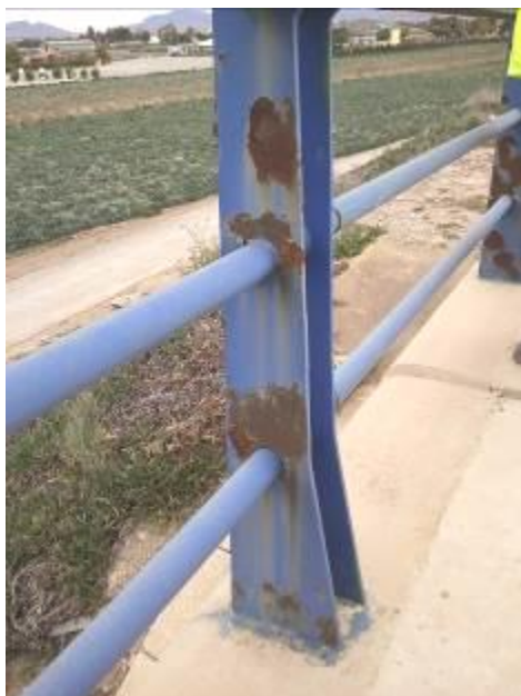
Figura 1. Estado inicial del pretil metálico o barandilla.
