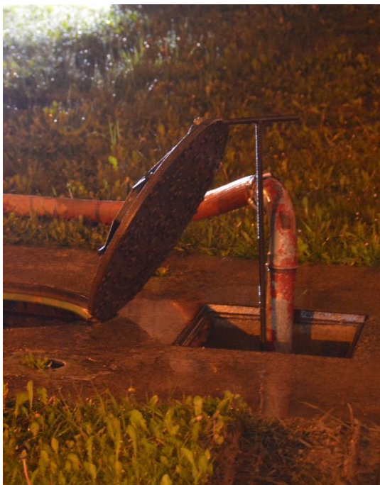
Figura 3. Captación de agua
